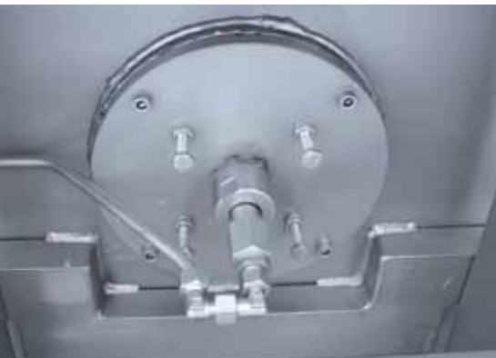
Sistema de desgasificación / Degassing System
